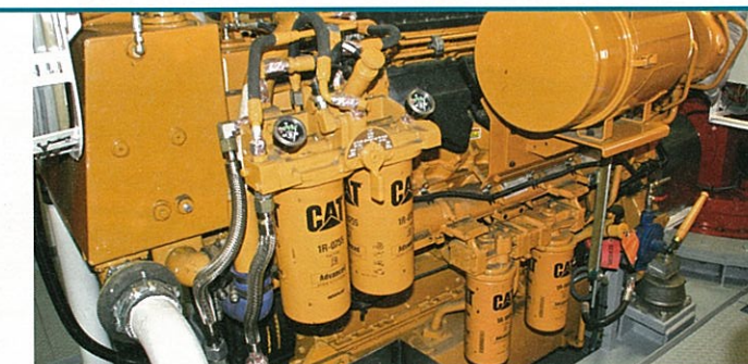
Einen der beiden Hauptantriebsmotoren vom Typ CAT C32
